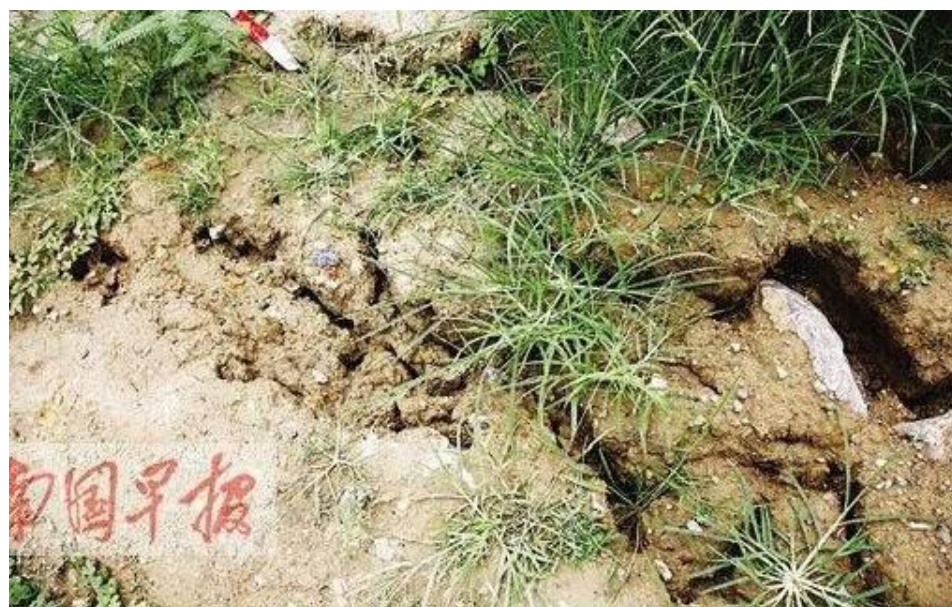
图四：滑坡两侧羽状裂缝和剪切裂缝（二）
